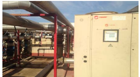
ENFRIADORA A SUSTITUIR POR UNA BOMBA DE CALOR
