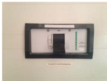
CUADROS ELÉCTRICOS EXISTENTES
